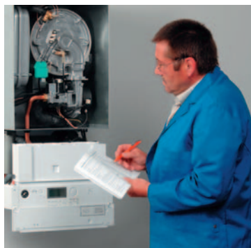
Fachowa konserwacja – w wyspecjalizowanej firmie zajmującej się Państwa instalacją grzewczą – w najlepszych rękach
